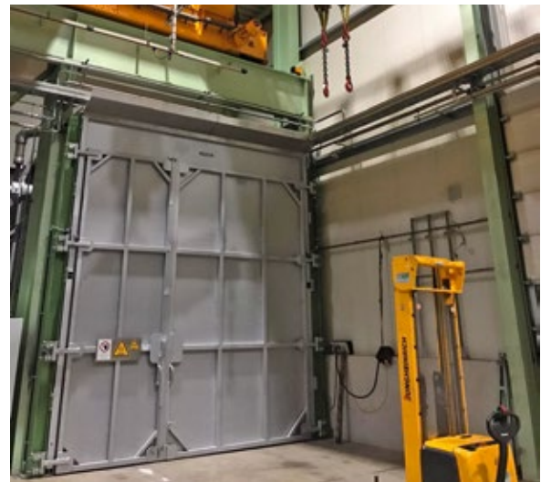
Blick von außen auf die innovative Wärmekammer der Carl KRAFFT & Söhne GmbH & Co. KG
