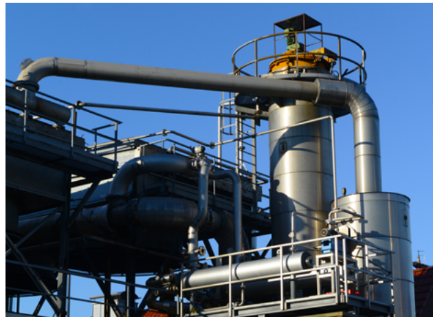
Die mit Abwärme gespeiste Trocknungsanlage führte zu hohen Prozessenergieersparnissen. Im Bild die Wärmeauskopplung.
